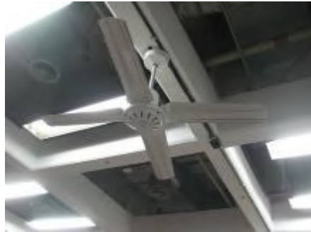
Ventiladores de techo
