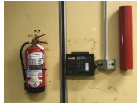
Matafuegos del pasillo
